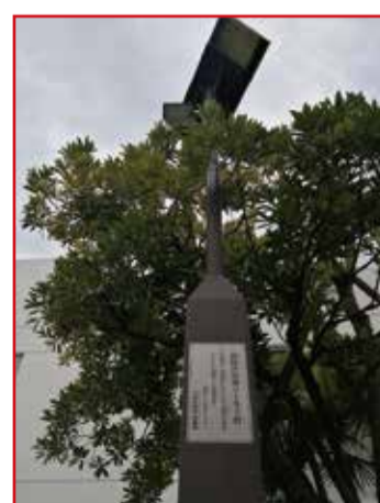
避難所誘導ソーラー灯
